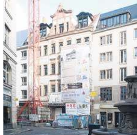
Wo jetzt noch der rote Kran steht, soll im Sommer ein Freisitz einladen.
